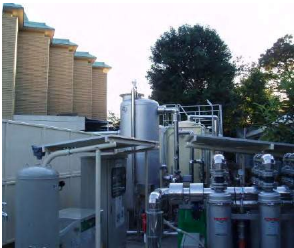
▲椿山荘 深層地下水活用システム
