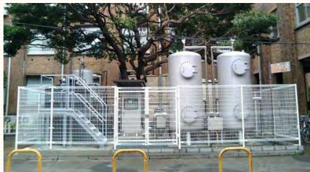
東京大学医学部付属病院 深層地下水活用システム
