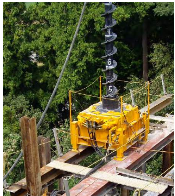
▲RTP-100C現場（熊本県）
