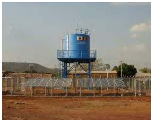
▲マリ 完成した給水塔とソーラーパネル
