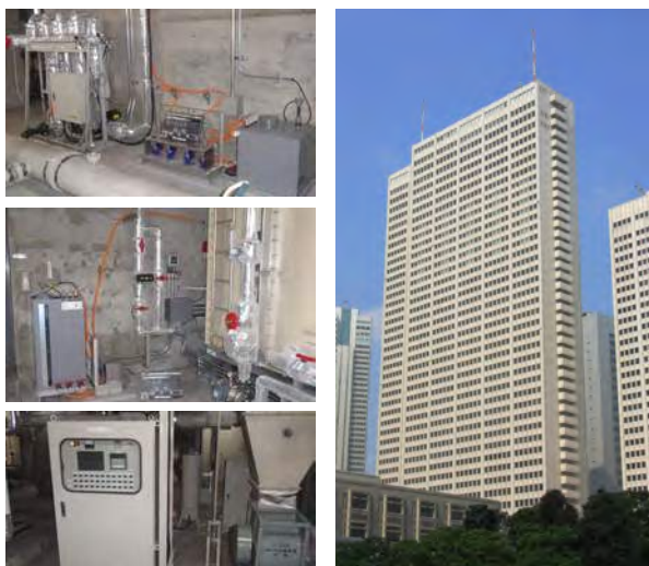
▲京王プラザホテル 深層地下水活用システム
