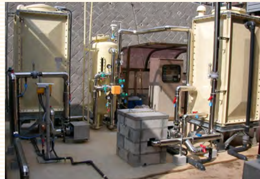
セントラルウェルネスクラブ能見台 深層地下水活用システム KWS-7.2-CWN
