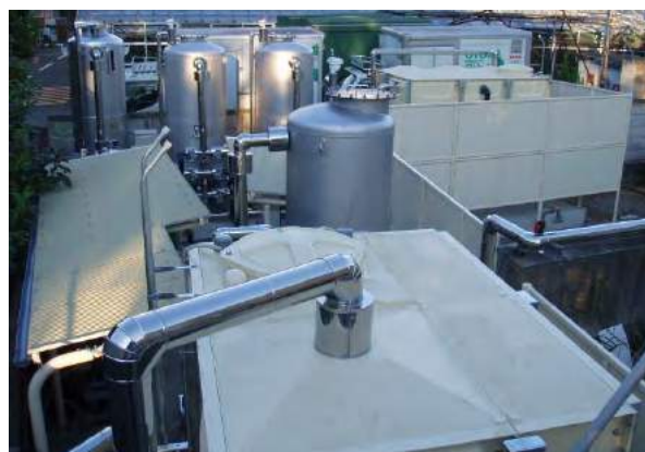
▲深層地下水活用システム 浄水プラント（東京・椿山荘）
