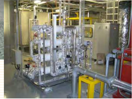
淡路夢舞台 深層地下水活用システム
